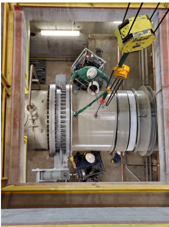
Hassayampa Unit 3 Discharge Valve
